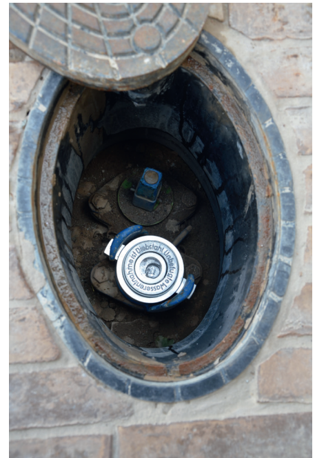
Hydrantenverschluss HV 80 am Hydranten DN 80
