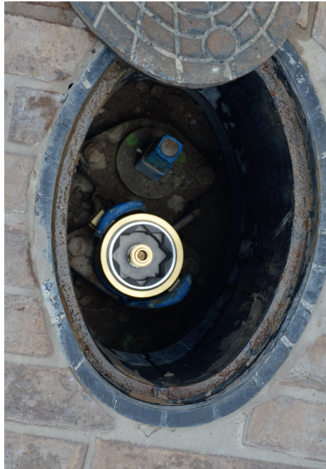
Hydrantenverschluss mit Schnellverschluss NW 7.2 am Hydranten DN 80
